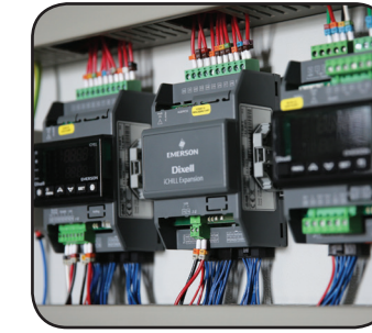
CE Standartlarında Güç ve Kontrol Panosu Power and Control Panel with CE 2006/95/EC Standards
