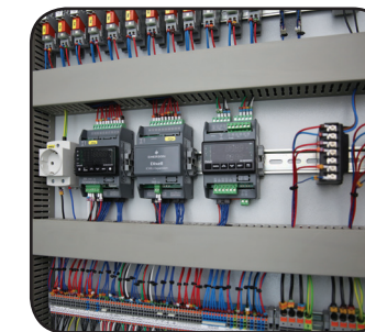
CE Standartlarında Güç ve Kontrol Panosu Power and Control Panel with CE 2006/95/EC Standards
